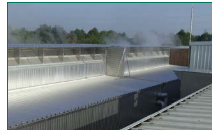
Trockenkammern mit Wärmerückgewinnung
